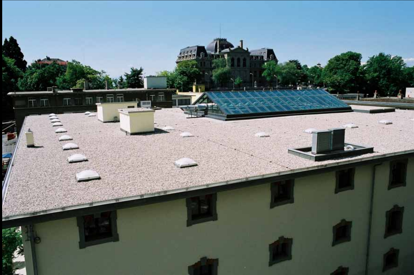
Route de Genève 17. Panneaux solaires
