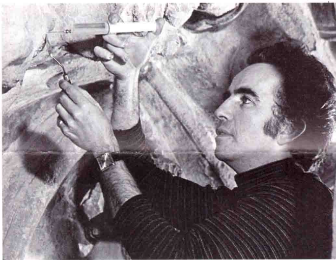
Théo-Antoine Hermanès. Injection à la seringue d'un produit de consolidation de la pierre.
